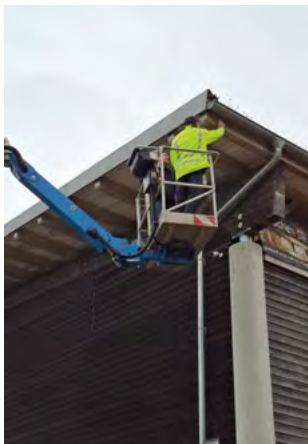
Begutachtung der Schäden
